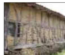
Structure en pans de bois, pisé et soubassement de pierres Source : L'Artifex
